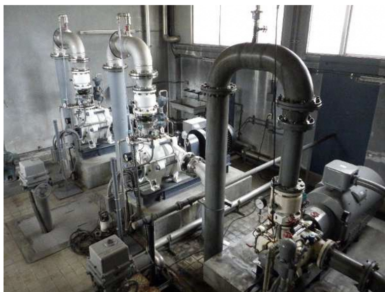
写真 2.9 佐古浄水場配水ポンプ
