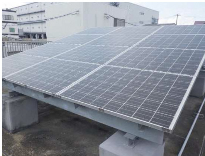
写真 7.1 佐古浄水場の太陽光発電システム
